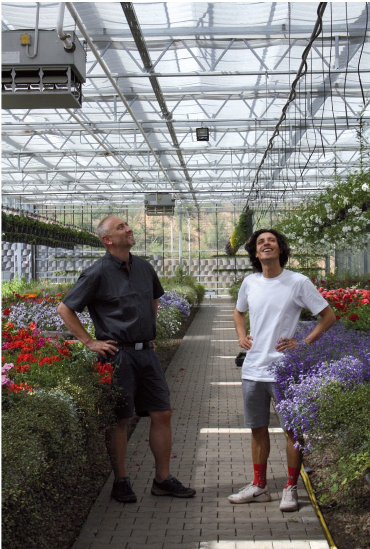
Computergesteuerte Energieschirme sorgen für die nötige Schattierung im Gewächshaus
